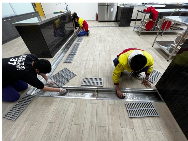
用過家政教室要清理排水溝
